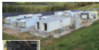
▲北海道釧路市内 大型蓄電池
